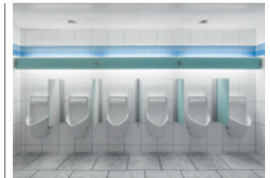
↑ Vorher: Die alten Urinale sind störanfällig geworden und verursachen viel Unterhaltsaufwand.
